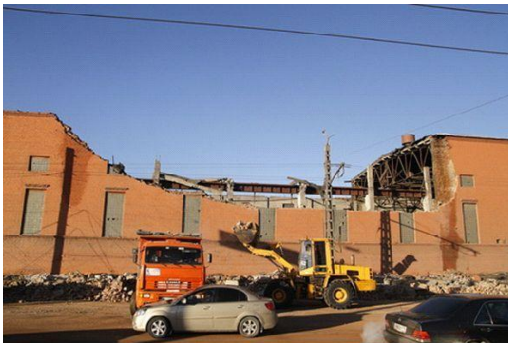
Рис. 11 – Разрушенный при воздушном взрыве метеороида корпус Челябинского цинкового завода 15 февраля 2013 года [27]
