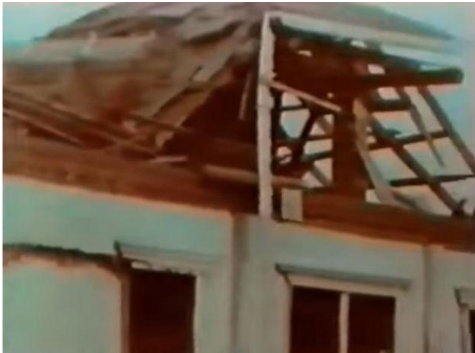
Рис. 4 – Разрушения дома испытателей Семипалатинского полигона
