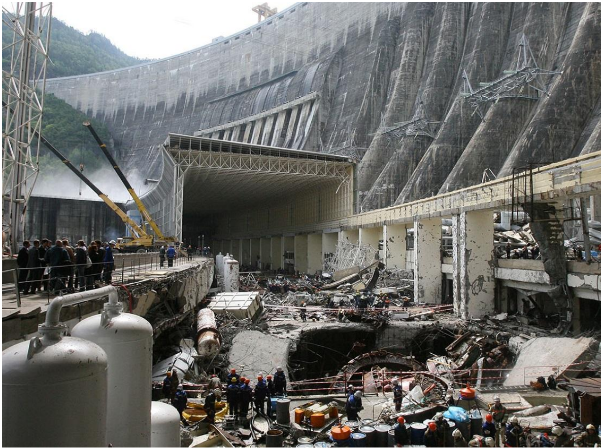
Рис. 4 – Вид разрушенного машинного зала Саяно-Шушенской ГЭС после катастрофы
